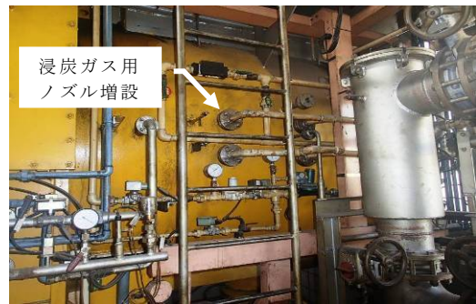
図 2.8 浸炭ガスノズル追加後の外観
