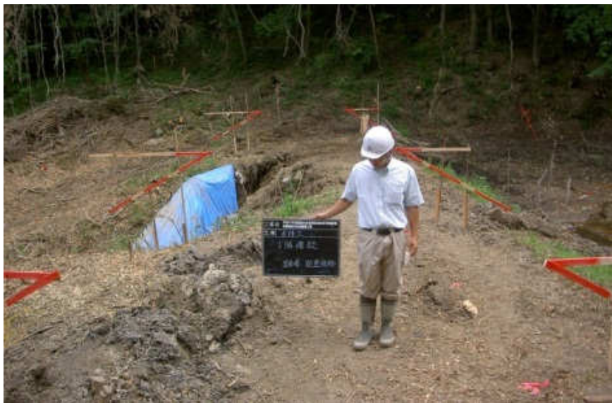
写真 2-11 堤体変状の状況
