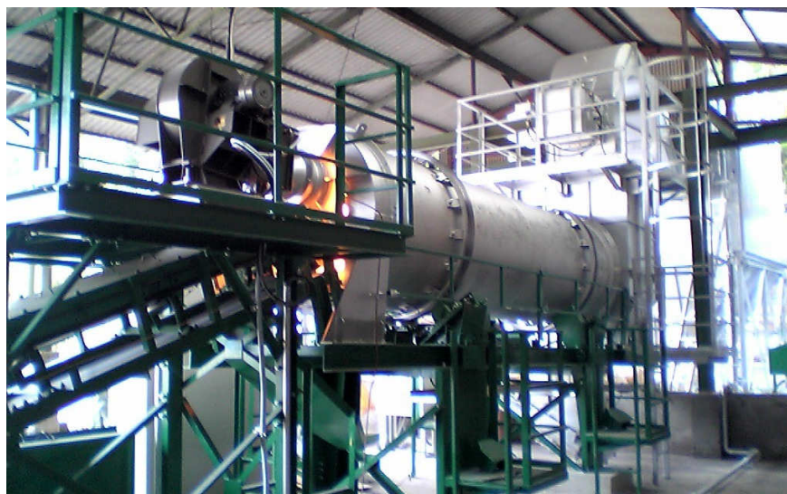
写真2-1 焼成中のロータリーキルン
