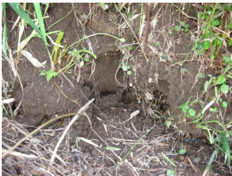
写真 3-2 堤体のり尻から湧水状況
