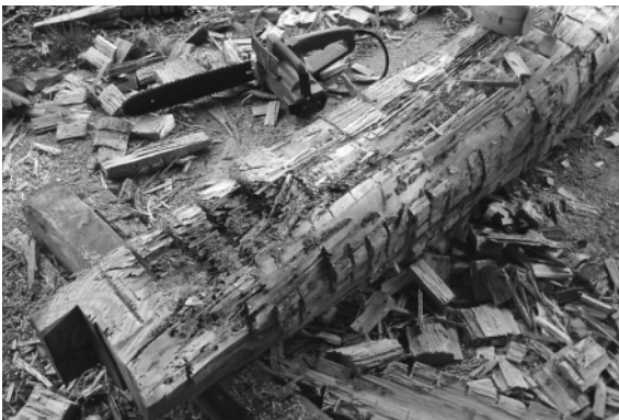
写真17 シロアリによる損傷部の切削
